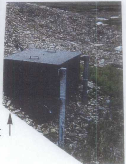
ELECTRIC CONDUIT BOX
